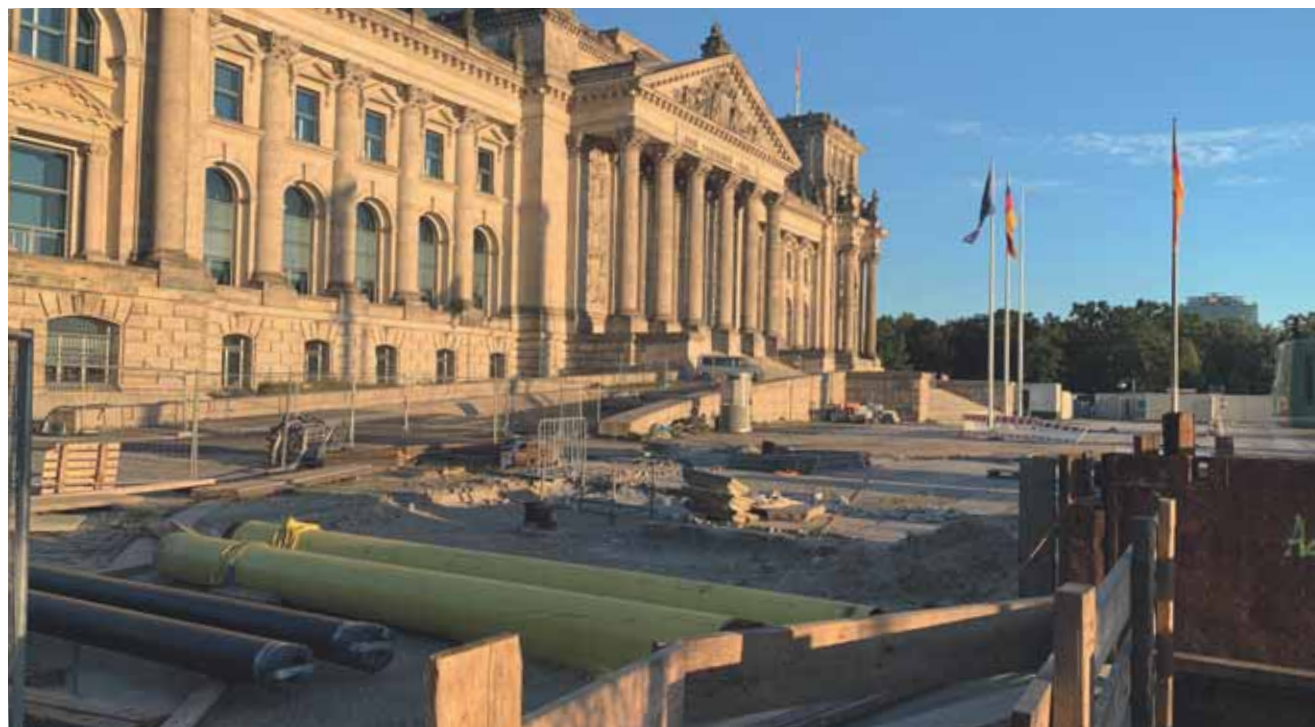
Nahezu sinnbildlich für die aktuelle politische Situation: die Großbaustelle am Deutschen Bundestag.
